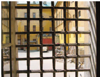
Abb. 24 Innenhof mit verschlissenem Anstrich in Schönbrunnengelb
