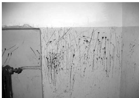
Abb. 10 Vandalismus Justizwache – Schlagstockspuren auf altrosa Wand
